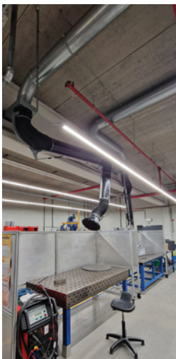
Absaugarme, verbunden mit einer zentralen Filtrationseinheit.
