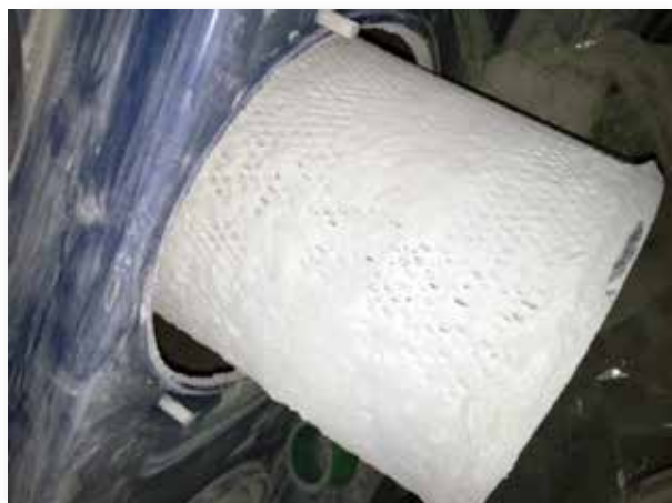
①フィルター目詰まり事例
