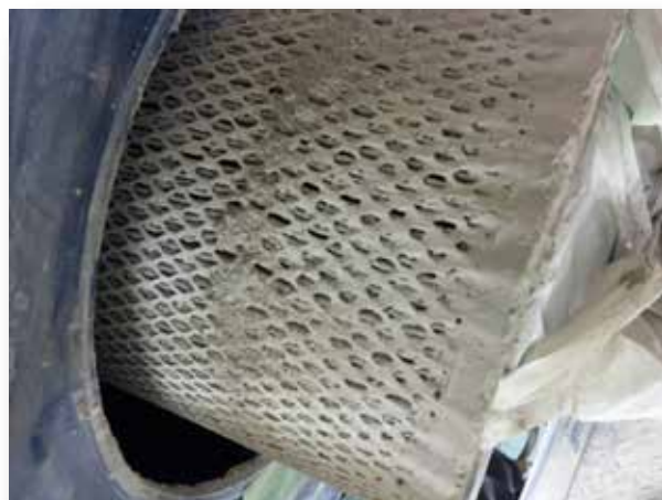
②フィルター目詰まり事例
