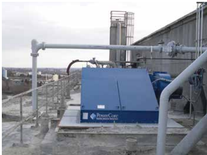
CPV - セメントサイロ (8,154 m 3 / h)
