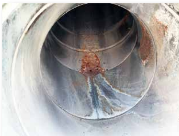
④吸気ダクトからの雨水浸入
