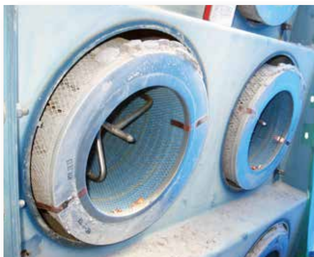
③フィルター目詰まり事例
