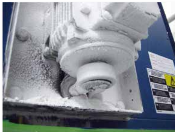
▲長期運転によりシール劣化（UMA シェーキング）
