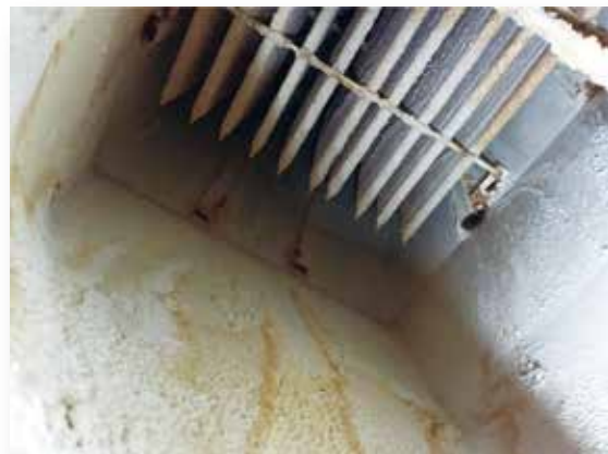
▲長期運転によりシール劣化・雨水浸入（ホッパー）
