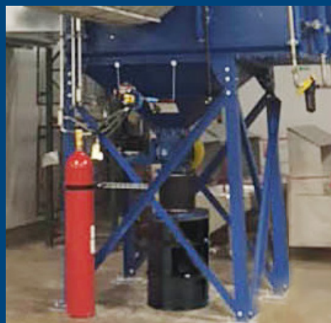
Supressão de incêndio
